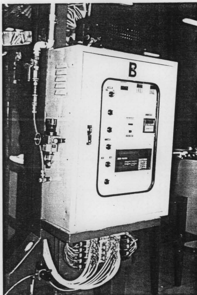
รูปที่ 3.20 การติดตั้งเครื่องมือวัดในตู้ควบคุมชุด B
