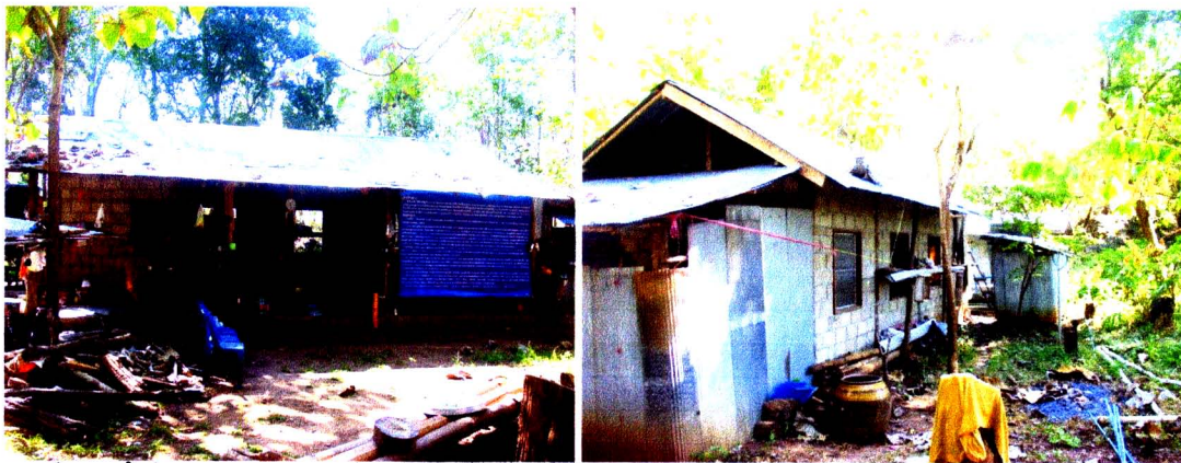
ภาพที่ 4.10 พื้นที่อาคารสำนักสงฆ์เดิมที่มีความทรุดโทรมควรย้ายที่และปรับเป็นอาคารนิทรรศการ
