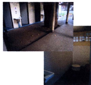
ทางเข้าห้องน้ำ ห้องน้ำ อ่างล้างมือ
