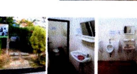
ทางเข้าหีองน้ำ หีองน้ำ ขาดสิ่งอำนวยความสะดวก
