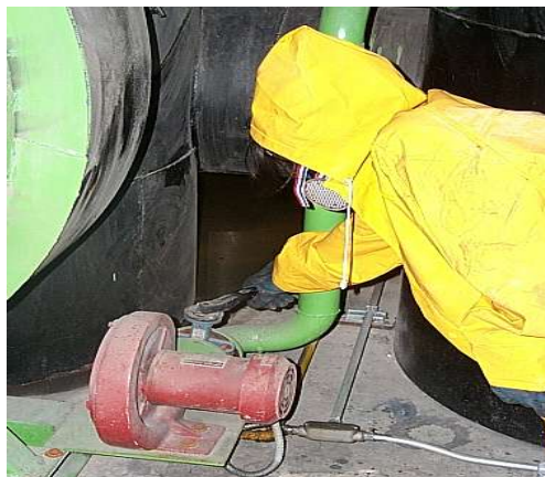
ภาพที่ 20 การปรับวาล์วปรับปริมาณอากาศ
