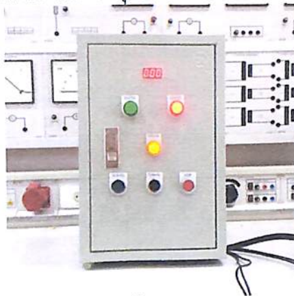
รูปที่ 4.6 แสดงการติดตั้งระบบควบคุมส่วนฮาร์ดแวร์
