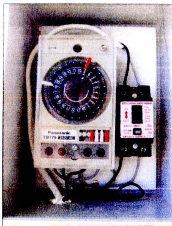
ภาพ 38 เครื่องควบคุมการเปิด-ปิดระบบไฟ
