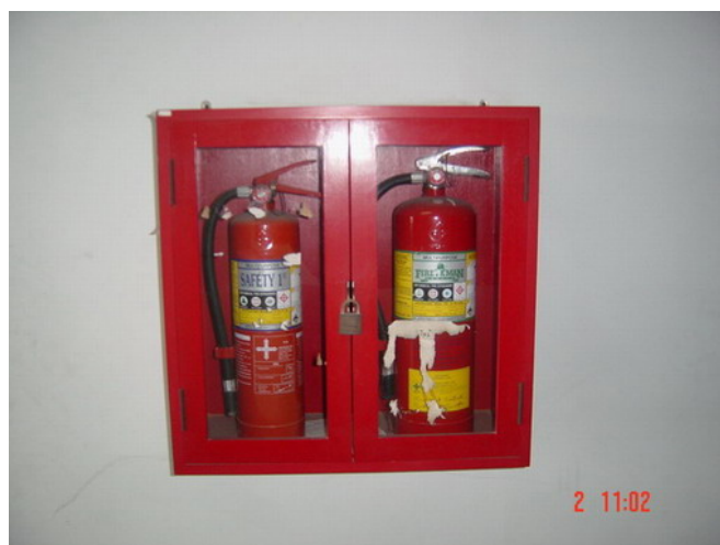
ภาพที่ 57 ตู้เก็บเครื่องดับเพลิงที่ติดตั้งในอาคาร
