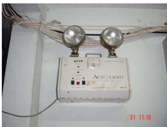
ภาพที่ 29 ไฟฉุกเฉินบริเวณโถงบันไดและลิฟท์
