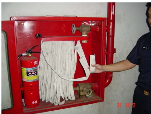
ภาพที่ 55 ตู้หัวฉีดน้ำดับเพลิงที่ถูกตัดหัวฉีดน้ำและข้อต่อเกลียว
