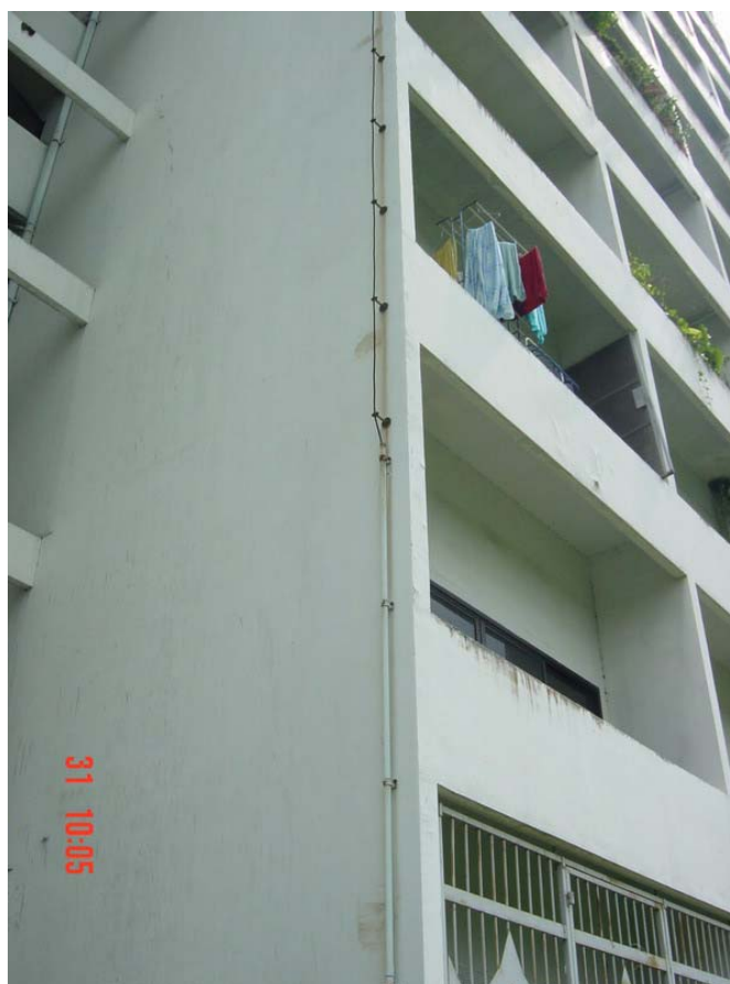
ภาพที่ 73 สายนำลงดินของอาคาร
