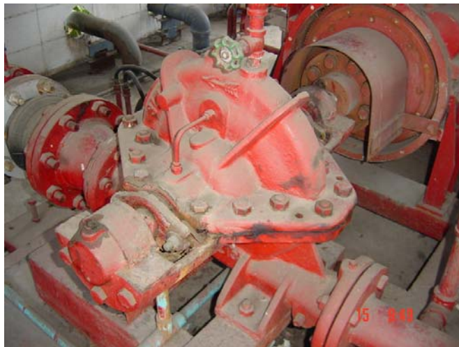
ภาพที่ 36 เครื่องสูบน้ำดับเพลิง
