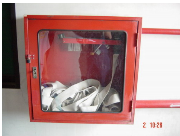
ภาพที่ 53 ตู้หัวฉีดน้ำดับเพลิงที่ไม่พร้อมใช้งาน
