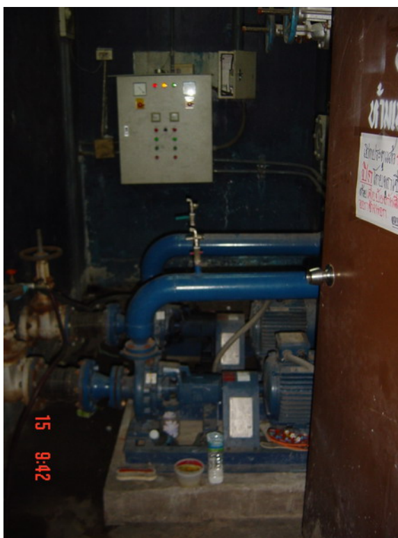
ภาพที่ 12 เครื่องสูบน้ำประปาและตู้ควบคุมเครื่องสูบน้ำ
