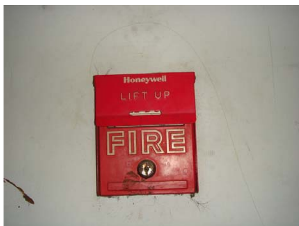
ภาพที่ 68 อุปกรณ์เริ่มสัญญาณแจ้งเหตุด้วยมือ (Manual Station)
