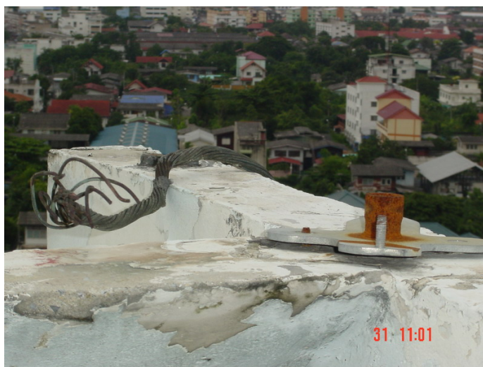
ภาพที่ 70 จุดต่อสายนำลงดินที่อยู่ในสภาพไม่สมบูรณ์
