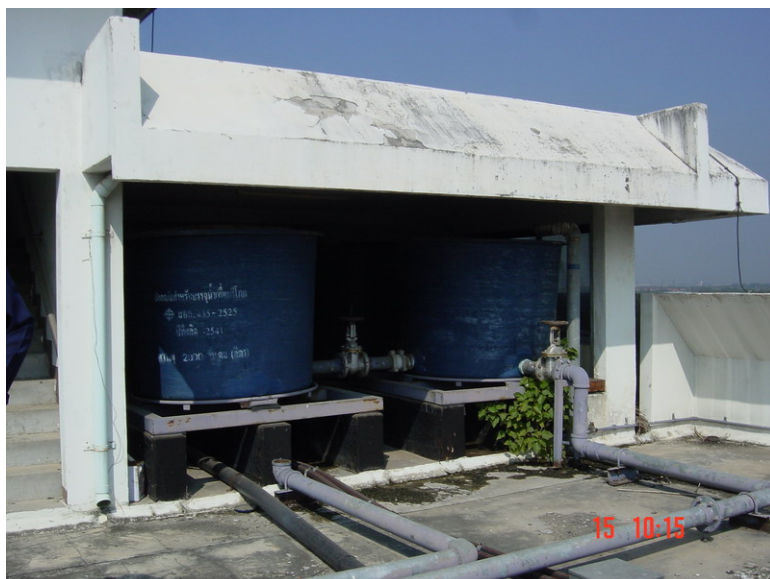
ภาพที่ 9 ถังเก็บน้ำบนดาดฟ้าของอาคาร
