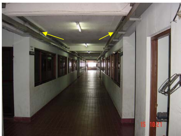
ภาพที่ 28 รางร้อยสายไฟฟ้าภายในอาคาร
