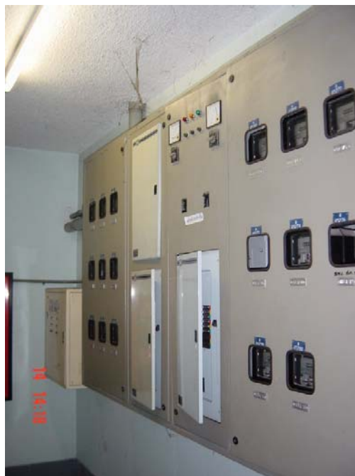
ภาพที่ 27 ห้องควบคุมระบบไฟฟ้าภายในอาคาร
