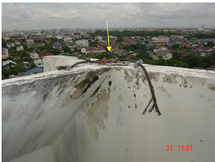
ภาพที่ 71 จุดต่อสาขนำลงดินที่อยู่ในสภาพไม่สมบูรณ์
