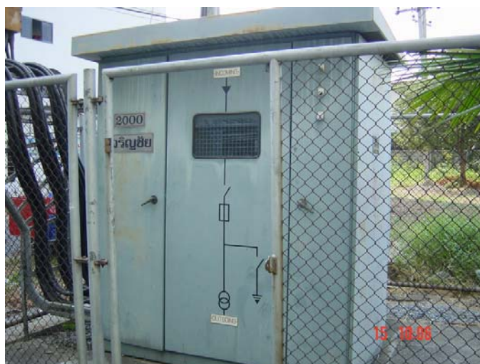
ภาพที่ 26 หม้อแปลงไฟฟ้าจากการไฟฟ้านครหลวง
