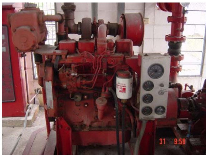
ภาพที่ 37 เครื่องยนต์เครื่องสูบน้ำดับเพลิง
