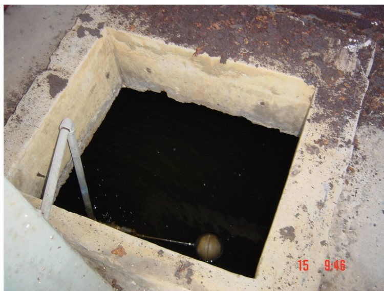
ภาพที่ 33 ถังเก็บน้ำดับเพลิง
