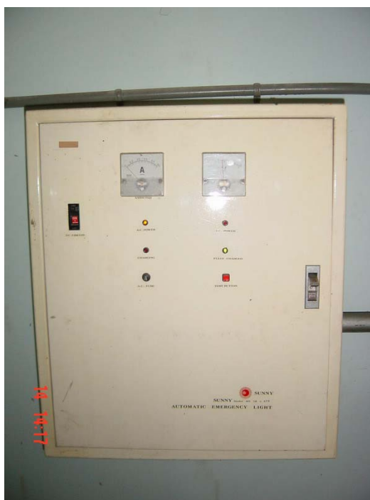
ภาพที่ 32 ตู้ควบคุมไฟฉุกเฉินบริเวณทางเดิน
