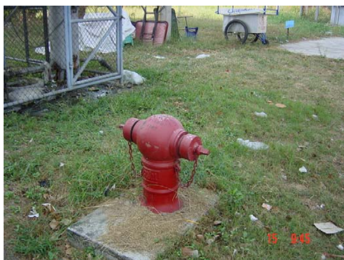
ภาพที่ 43 หัวจ่ายน้ำดับเพลิง
