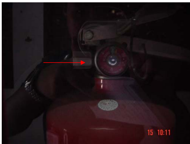
ภาพที่ 58 มาตรวัดความดันของเครื่องดับเพลิงแบบมือถือ
