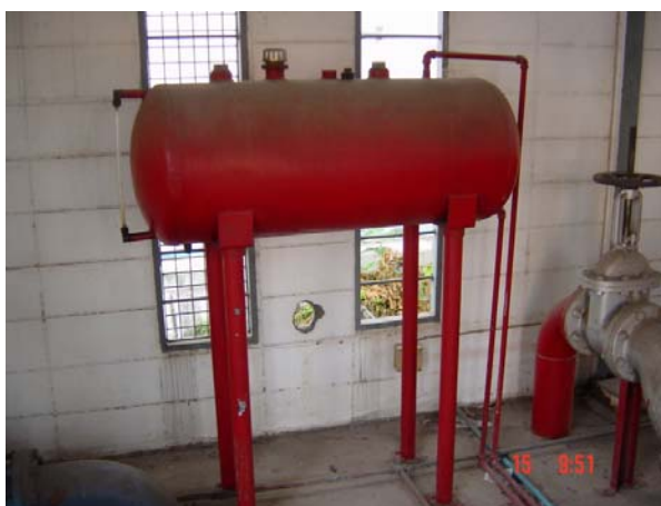
ภาพที่ 39 ถังน้ำมันสำหรับเครื่องสูบน้ำดับเพลิง
