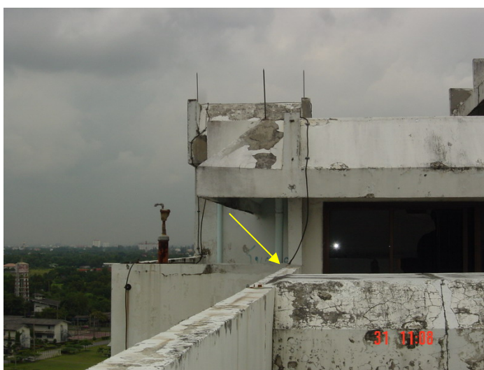
ภาพที่ 72 จุดต่อสาขนำลงดินที่อยู่ในสภาพไม่สมบูรณ์
