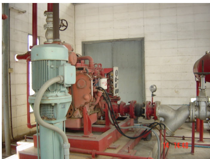
ภาพที่ 35 ภายในห้องเครื่องสูบน้ำดับเพลิง
