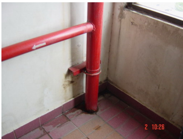
ภาพที่ 47 ท่อขึ้นชั้น 11 ที่รั่วซึม
