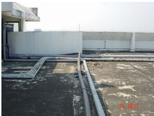
ภาพที่ 13 ท่อส่งน้ำบนดาดฟ้าของอาคาร
