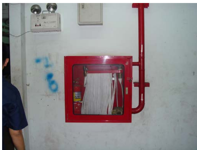
ภาพที่ 59 เครื่องดับเพลิงที่ติดตั้งภายในตู้หัวฉีดน้ำดับเพลิง
