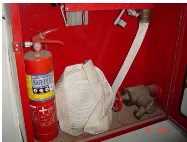
ภาพที่ 56 ตู้หัวฉีดน้ำดับเพลิงที่ไม่พร้อมใช้งาน
