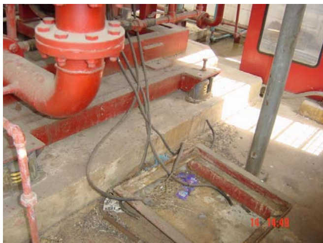
ภาพที่ 38 แท่นวางแบตเตอรี่ของเครื่องสูบน้ำดับเพลิง
