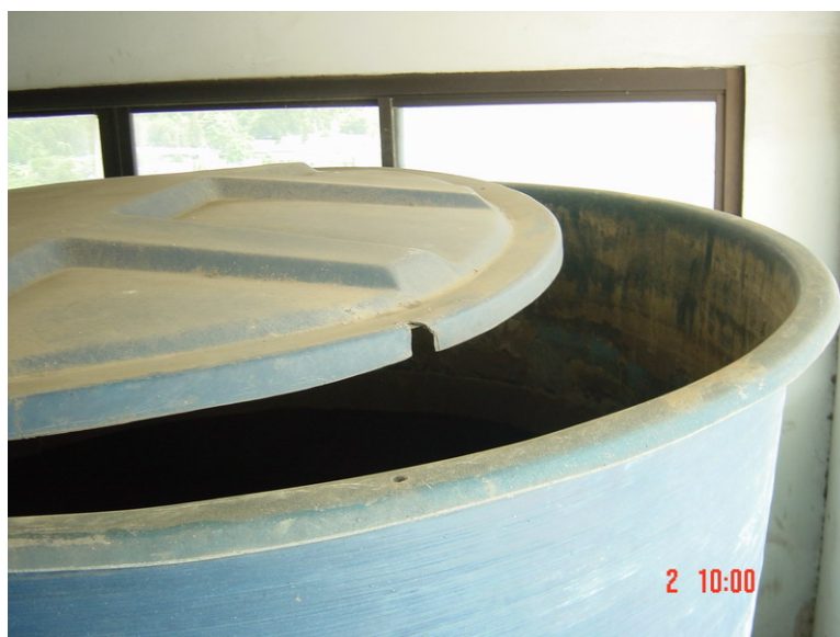
ภาพที่ 11 ฝาดังเก็บน้ำที่ไม่ได้ปิด
