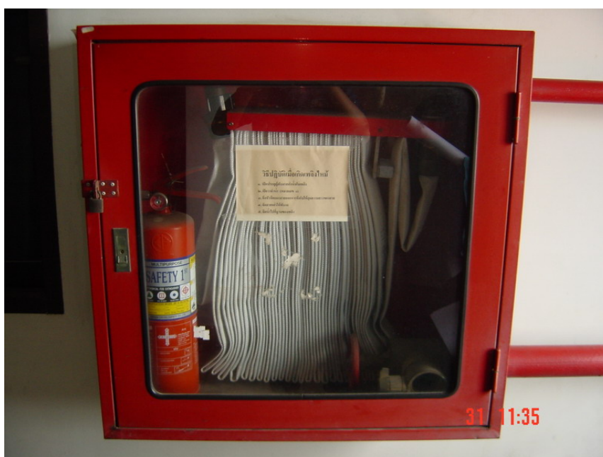
ภาพที่ 49 ตู้หัวฉีดน้ำดับเพลิงที่อยู่ในสภาพสมบูรณ์
