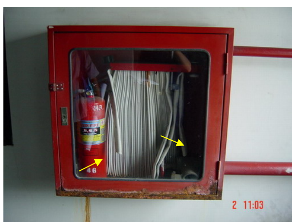
ภาพที่ 52 ตู้หัวฉีดน้ำดับเพลิงที่ไม่พร้อมใช้งาน
