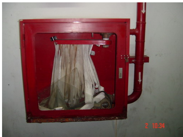
ภาพที่ 54 ตู้หัวฉีดน้ำดับเพลิงที่ไม่พร้อมใช้งาน
