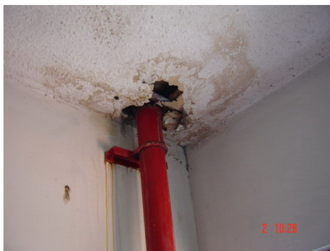
ภาพที่ 48 ท่อขึ้นชั้น 11 ที่รั่วซึม
