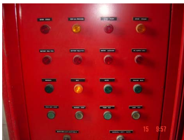
ภาพที่ 41 ตู้ควบคุมเครื่องสูบน้ำดับเพลิง
