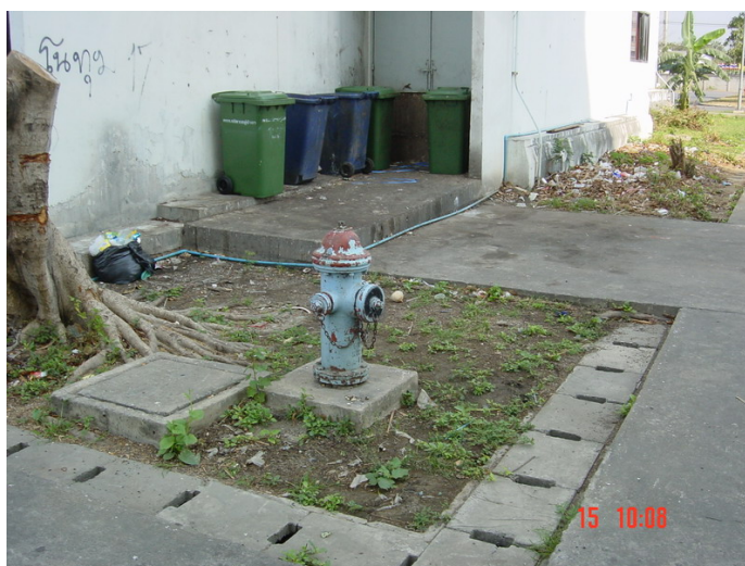
ภาพที่ 42 หัวรับน้ำดับเพลิง
