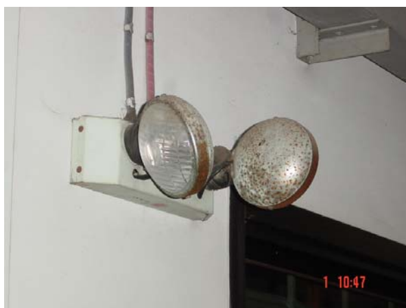
ภาพที่ 30 ไฟฉุกเฉินบริเวณทางเดิน
