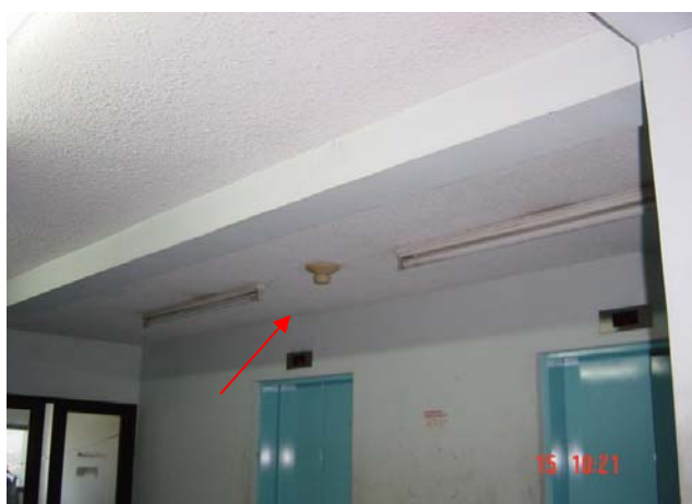
ภาพที่ 23 อุปกรณ์ตรวจจับควันไฟบริเวณโถงหน้าลิฟท์
