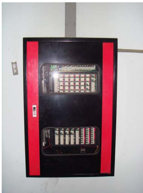
ภาพที่ 62 แผงควบคุมระบบแจ้งเตือนอัคคีภัย (Fire Alarm Control Panel)
