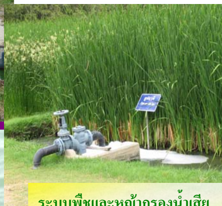
ระบบบ่อบำบัดน้ำเสีย (lagoon treatment)
