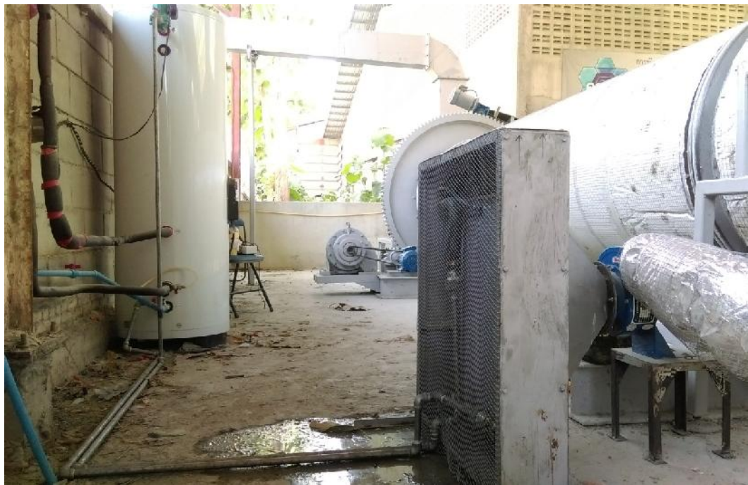
ภาพที่ 3.23 การติดตั้งอุปกรณ์แลกเปลี่ยนความร้อนร่วมกับกระบวนการลดความชื้นแบบเป่าลมร้อน
