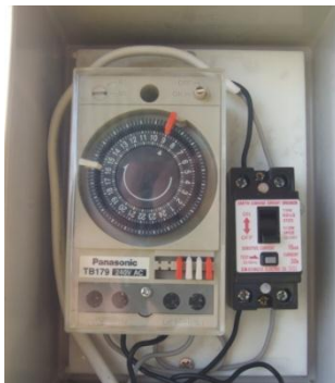
ควบคุมระยะเวลาของระบบ
