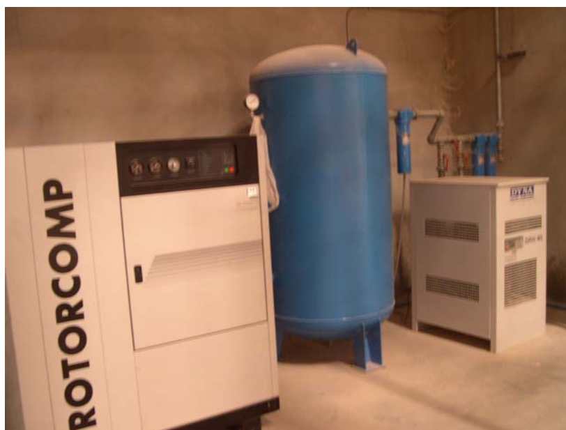
ภาพที่ 52 ชุด Air Compressor และ Air Dryer ซึ่งใช้ร่วมกับเครื่องตัดแยกสี
