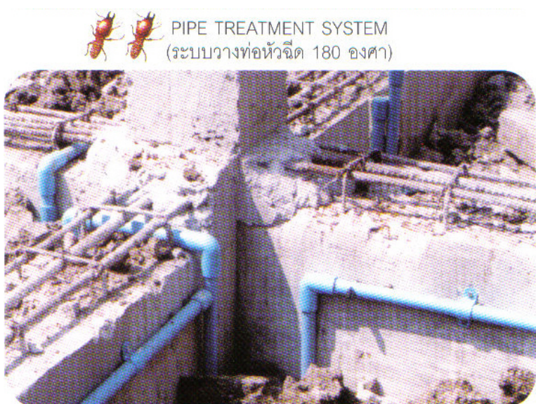
ภาพที่ 10 แสดงการติดตั้งระบบ PIPE TREATMENT SYSTEM ที่มา: สุทธิยา (2547)
