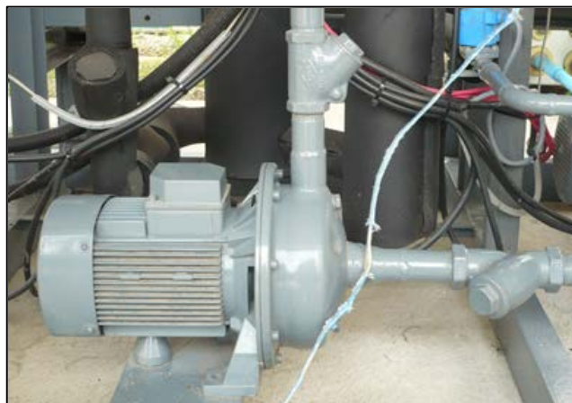
รูปที่ 3.10 ปั๊มน้ำหมุนเวียน
