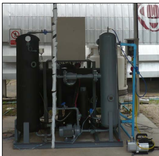
รูปที่ 3.1 ชุดทดสอบระบบทำความเย็น
