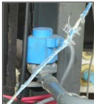
รูปที่ 3.8 วาล์วลดความดัน (Expansion Valve)
