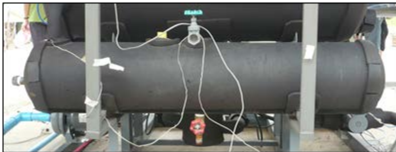
รูปที่ 3.7 ถังเก็บน้ำเย็น (Chill Water Storage Tank)
