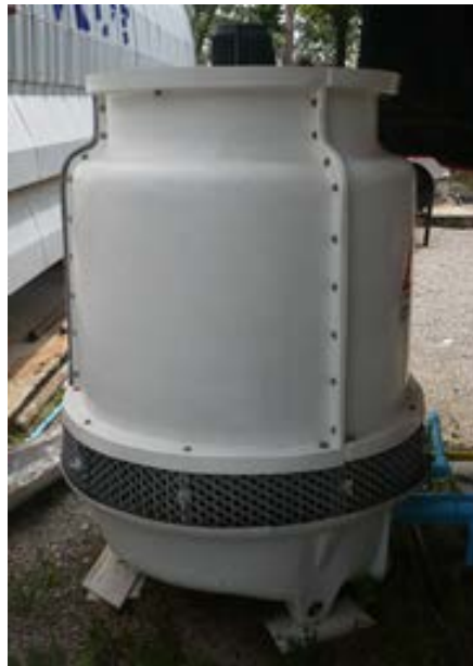
รูปที่ 3.9 หอผึ่งเย็น (Cooling Tower)
