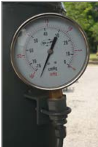
รูปที่ 3.13 เกจวัดความดัน (Pressure Gauge) ยี่ห้อ Denki
