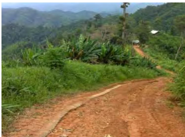
ภาพที่ 4.28 ถนนดินที่เทคอนกรีตเฉพาะให้มอเตอร์ไซด์วิ่งผ่านได้เท่านั้น และมักถูกน้ำกัดเซาะพังทลายและต้องซ่อมแซมเป็นประจำทุกปี
