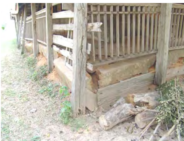
ภาพที่ 81 พื้นเพคอนกรีต ปัจจุบันทรุดโทรมลงมาก มุมด้านทิศตะวันตก วัดโนนพระ บ้านสงเปลือย ตำบลเสอเพลอ อำเภอกุมภวาปี จังหวัดอุดรธานี
