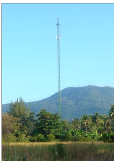
ภาพที่ 32 เสาสัญญาณโทรศัพท์เคลื่อนที่ระบบ DTEC ภายในชุมชน ภาพถ่ายจากการสำรวจชุมชน, 18 มีนาคม 2549.
