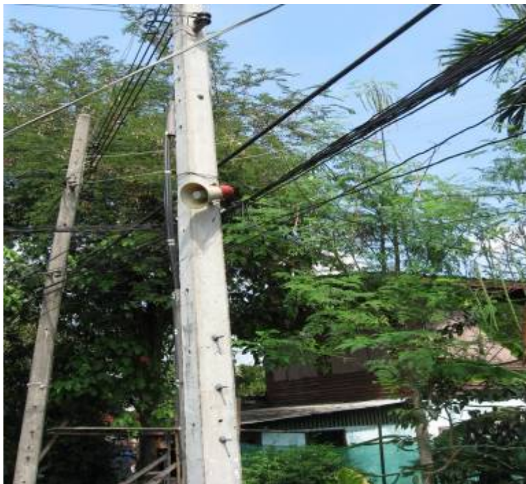
ลำโพงกระจายเสียงตามสายภายในชุมชน ที่ติดตั้งบริเวณเสาไฟฟ้ารอบชุมชน
