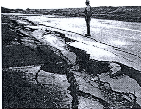
รูปที่ 2.16 ลักษณะของ Lateral spread ที่เกิดขึ้นบนถนนในประเทศสหรัฐอเมริกา สาเหตุจากแผ่นดินไหว ( คัดลอกจาก L.M. Highland and P. Bobrowsky, 2008)
