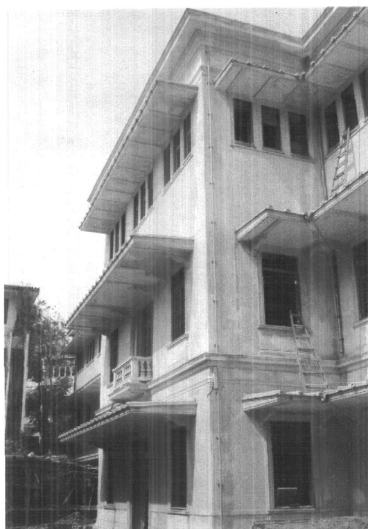
ผนังอาคารภายหลังการลอกสี
