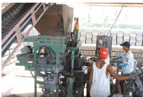
ภาพที่ จ.3(ค) เครื่องอัดขึ้นรูปคอนกรีตบล็อก
