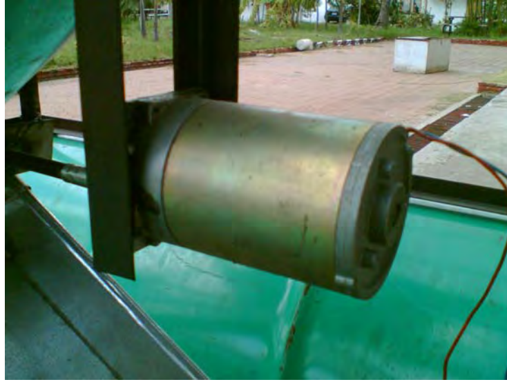
รูปที่ 3.7 มอเตอร์เกียร์ที่ใช้เลื่อนลิ้นปิดเปิด
