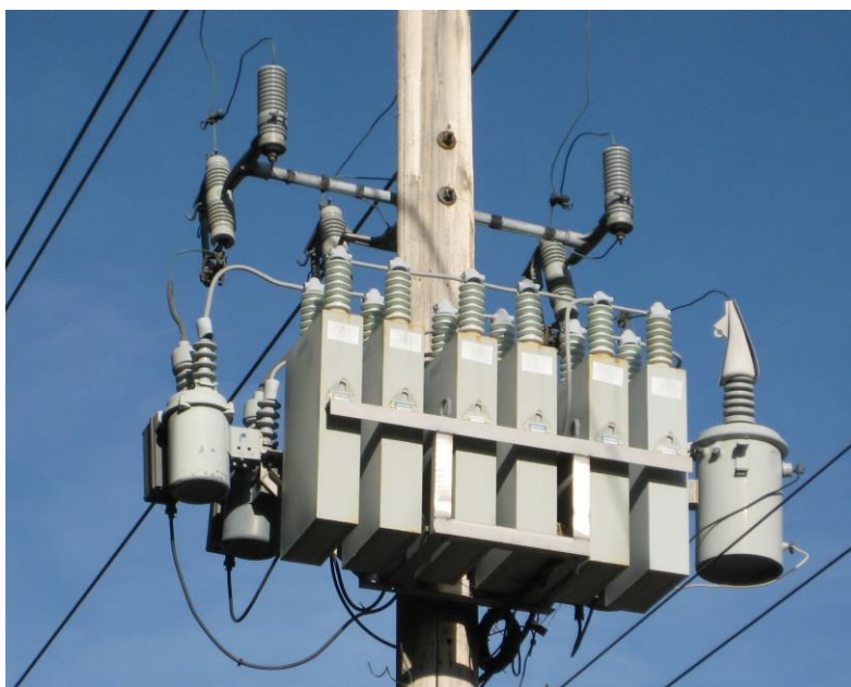
รูปที่ 2.12 ตัวเก็บประจุขนานสำหรับติดตั้งบนเสา
