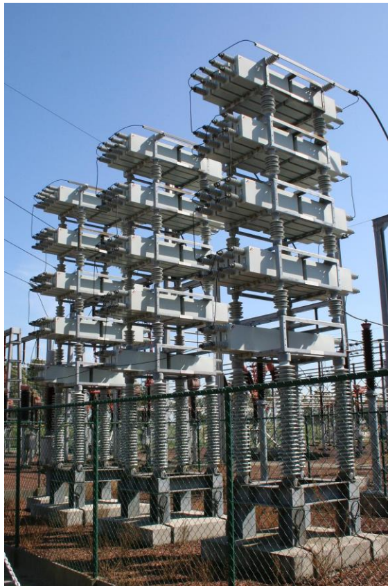
รูปที่ 2.10 ตัวเก็บประจุ ณ สถานีไฟฟ้าย่อยในระบบจำหน่าย
