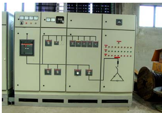
ภาพที่ 2.5 ตู้ควบคุมไฟฟ้า
