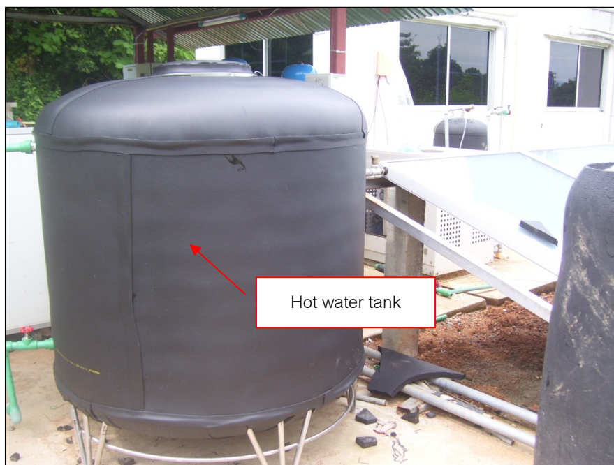
รูปที่ ๓.๔ ถังเก็บสะสมน้ำร้อนขนาด ๑,๕๐๐ liter
