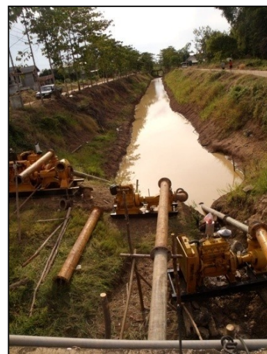
รูปที่ 7.11 โครงการสูบน้ำบ้านคลองนาทุ่ง หมู่ที่ 10 ต.บ้านกล้วย อ.เมือง จ.สุโขทัย วันที่ 23 สิงหาคม 2555
