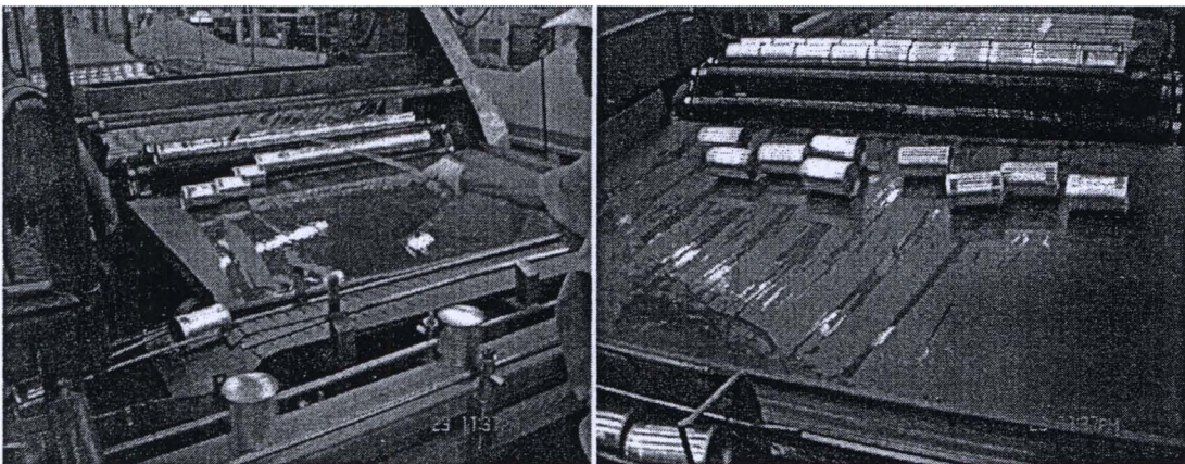
ภาพ 1.5 อุปกรณ์ลำเลียงกระป๋องจากรางฆ่าเชื้อมายังสายพานลำเลียงไม่เหมาะสม
