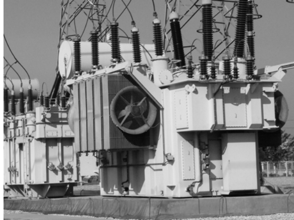
ภาพที่ 1-2 หม้อแปลงไฟฟ้ากำลังขนาด 3 เฟส 200 MVA 230/115 kV
