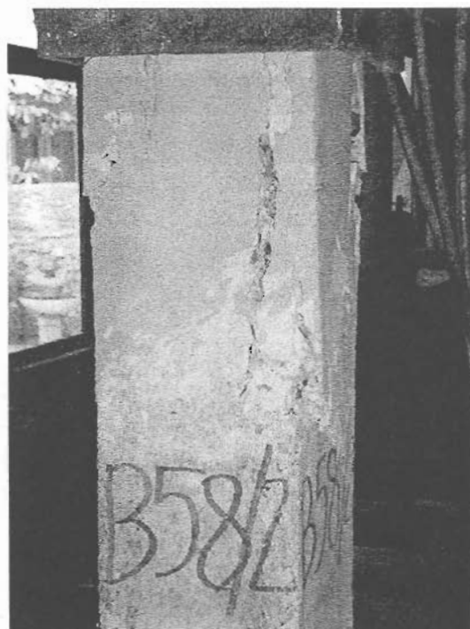
ภาพที่ 4-38 การวิบัติของเสา B58/2
