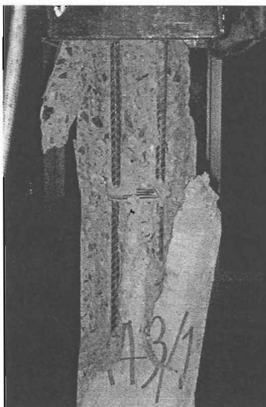
ภาพที่ 4-15 การวิบัติของเสา A43/1
