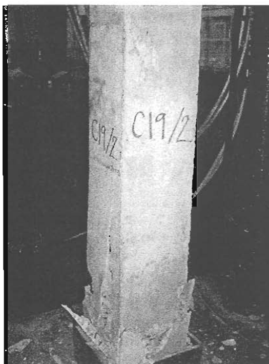
ภาพที่ 4-44 การวิบัติของเสา C19/2
