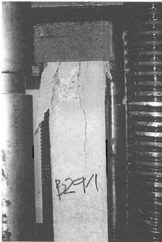
ภาพที่ 4-25 การวิบัติของเสา B29/1
