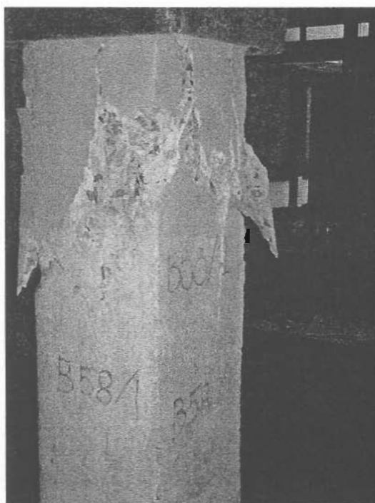
ภาพที่ 4-37 การวิบัติของเสา B58/1
