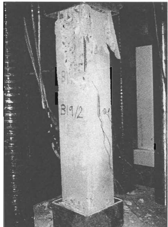
ภาพที่ 4-22. การวิบัติของเสา B19/2
