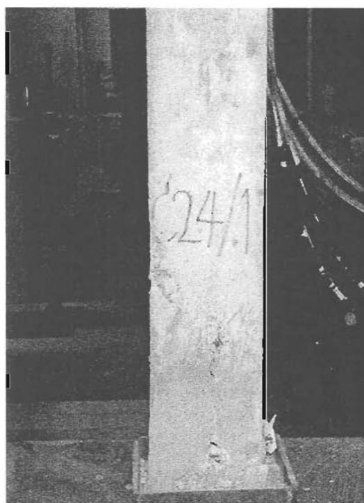
ภาพที่ 4-45 การวิบัติของเสา C24/1
