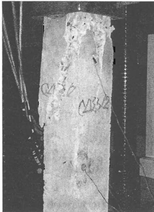
ภาพที่ 4-56 การวิบัติของเสา C48/2
