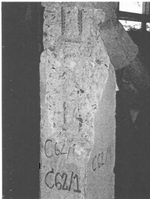
ภาพที่ 4-61 การวิบัติของเสา C62/1
