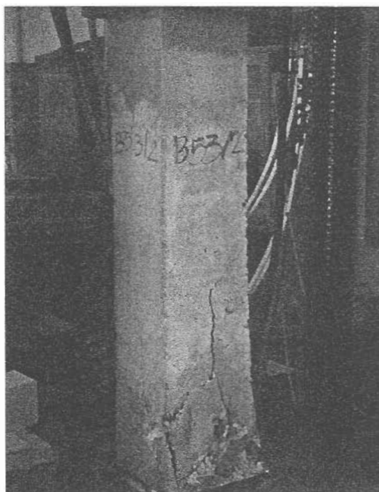
ภาพที่ 4-36 การวิบัติของเสา B53/2
