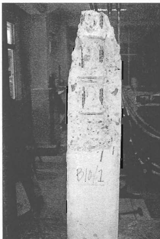
ภาพที่ 4-17 การวิบัติของเสา B10/1
