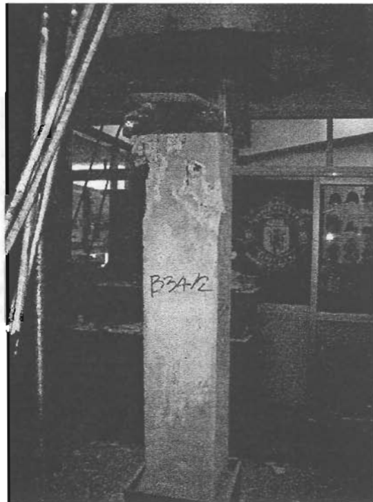
ภาพที่ 4-28 การวิบัติของเสา B34/2
