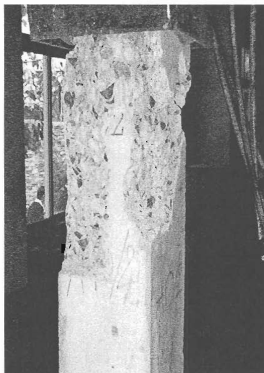
ภาพที่ 4-2 การวิบัติของเสา A10/2
