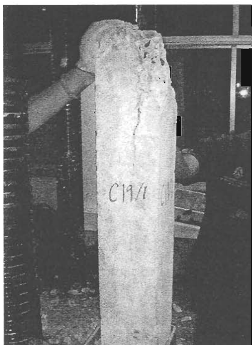
ภาพที่ 4-43 การวิบัติของเสา C19/1
