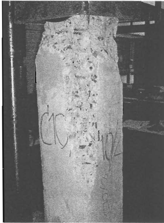
ภาพที่ 4-40 การวิบัติของเสา C10/2
