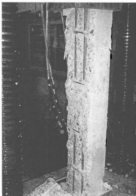
ภาพที่ 4-5 การวิบัติของเสา A19/1
