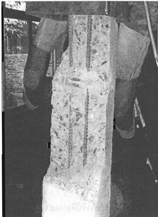
ภาพที่ 4-55 การวิบัติของเสา C48/1
