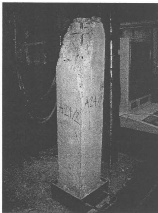
ภาพที่ 4-8 การวิบัติของเสา A24/2
