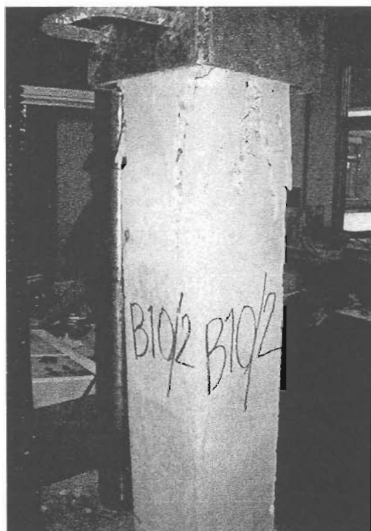
ภาพที่ 4-18 การวิบัติของเสา B10/2
