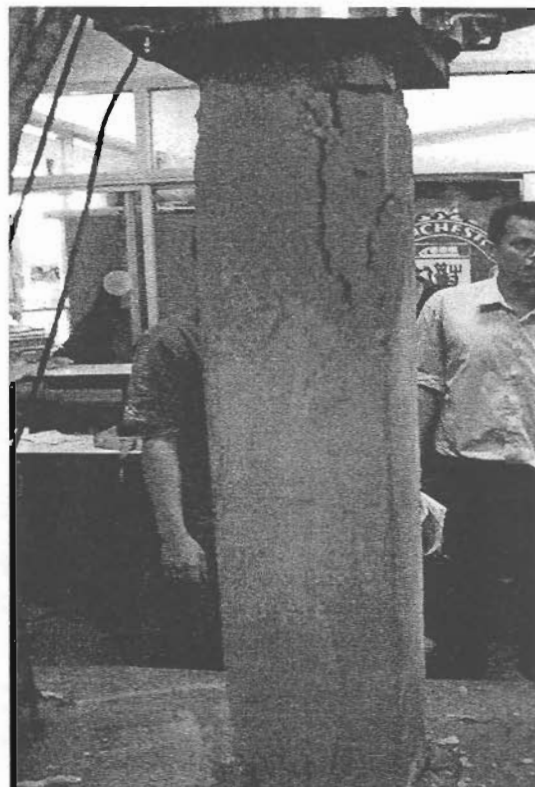
ภาพที่ 4-12 การวิบัติของเสา A34/2
