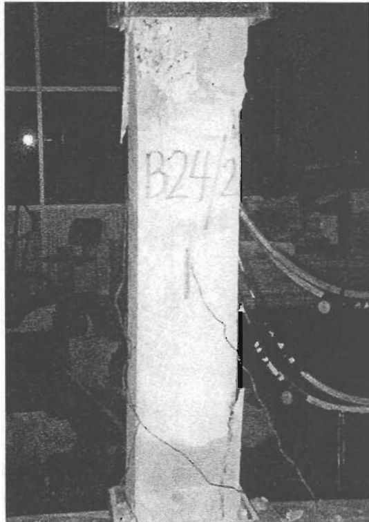
ภาพที่ 4-24 การวิบัติของเสา B24/2'
