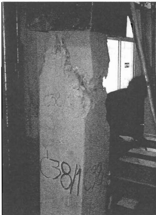
ภาพที่ 4-51 การวิบัติของเสา C38/1
