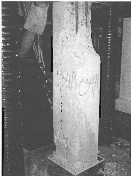
ภาพที่ 4-49 การวิบัติของเสา C34/1
