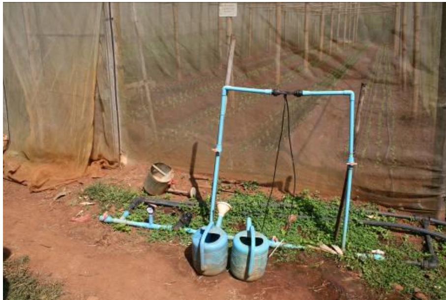
รูปที่ 5.31 ระบบเวนจูรี่ปั๊ม
