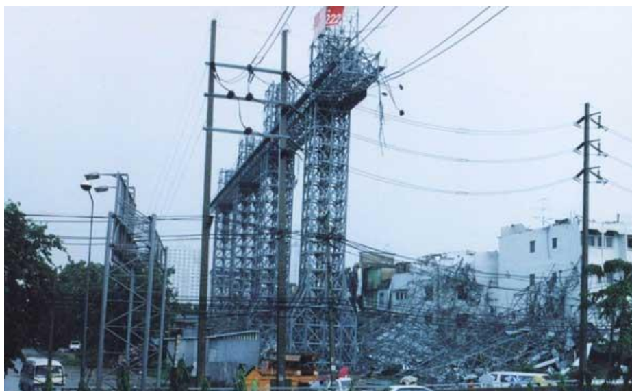
รูปที่ 1.1 ป้ายโฆษณาล้มทับอาคารพาณิชย์บริเวณสี่แยกบางนา มิถุนายน พ.ศ.2545 [12]
