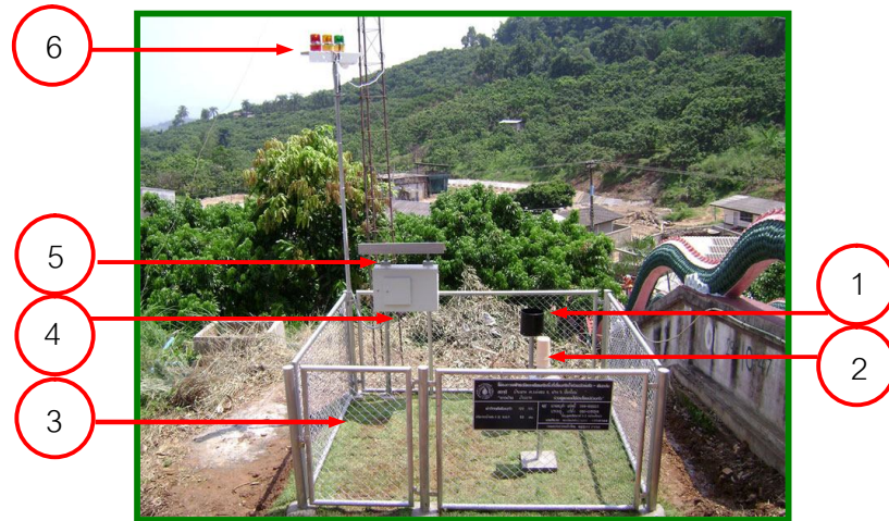
ภาพที่ 2.11 สถานีเตือนอุทกภัย-ดินถล่มแบบเตือนด้วยปริมาณน้ำฝน ของกรมทรัพยากรน้ำ (2552)
