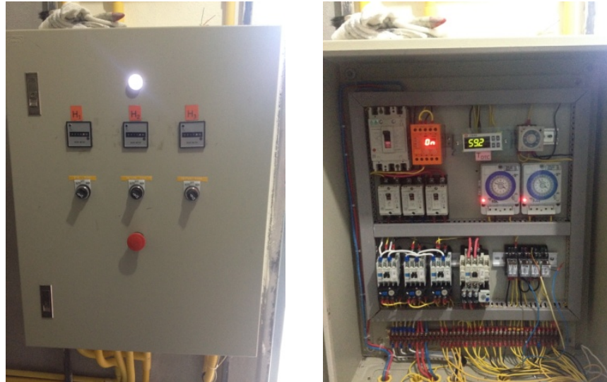
รูปที่ 3.12 ตู้ควบคุมการทำงาน
