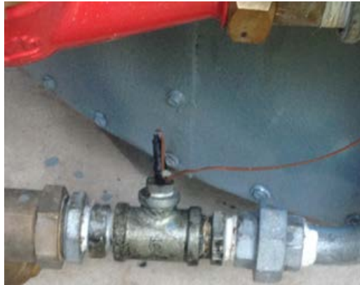
รูปที่ 3.5 ตำแหน่งวัดอุณหภูมิของน้ำดิบก่อนเข้าถังสะสมน้ำร้อน
