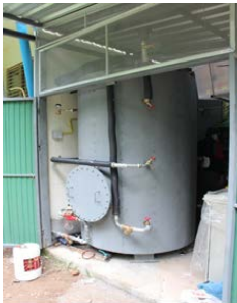
รูปที่ 2.11 ถังเก็บน้ำร้อน
