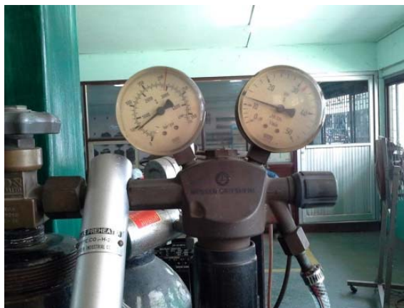
รูปที่ 3.7 ชุดควบคุมแก๊ส
