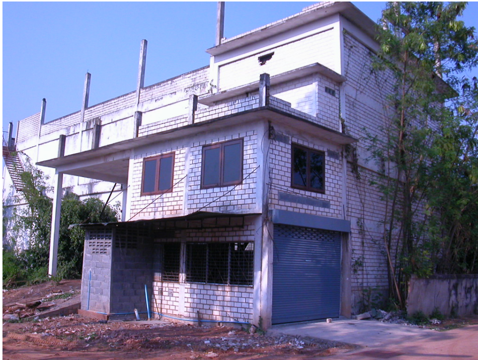
ภาพที่ 1 อาคารห้องเย็นที่ น.ส.ประภา แซ่อึ้ง เคยเป็นที่เก็บซากตุ๊กแกบ้าน
