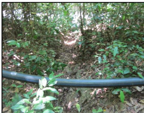
ภาพที่ 54 จุดที่ 6 ท่อน้ำประปา
