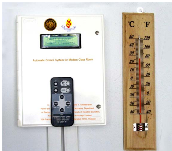
รูปที่ 4.1 เครื่องควบคุมอุปกรณ์ไฟฟ้าในห้องเรียน ระบบอัตโนมัติ
