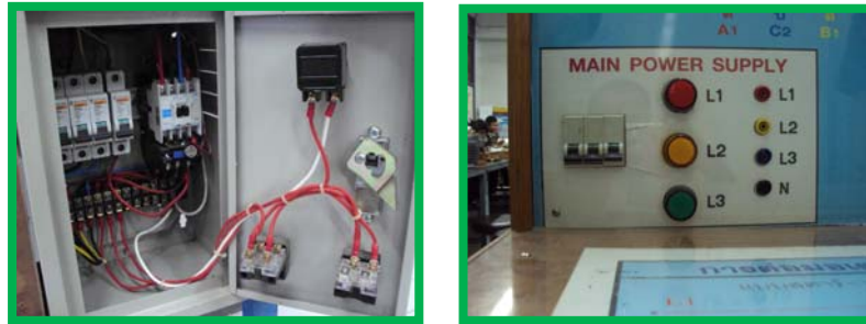
รูปที่ 4.4 การติดตั้งชุดควบคุมวงจรมอเตอร์ให้สตาร์ทหรือหยุดการทำงาน
