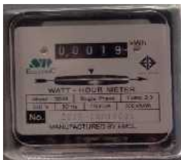
รูปที่ 3.9 เครื่องวัดหน่วยไฟฟ้า SR Electric
