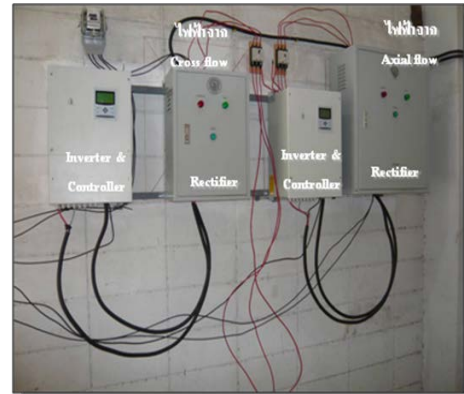
ภาพที่ 2-12 ตู้ควบคุมกระแสไฟฟ้าของกังหันน้ำทั้ง 2 ตัว
