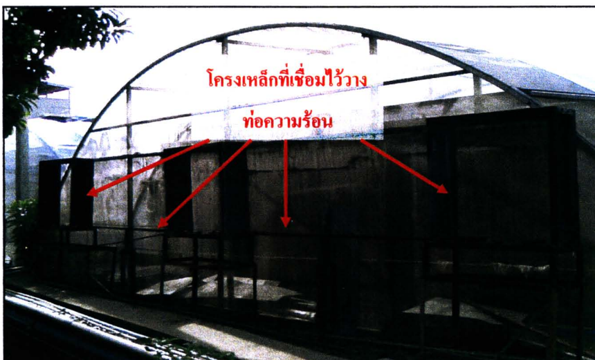
รูป 3.10 โครงสร้างที่ติดตั้งท่อความร้อน
