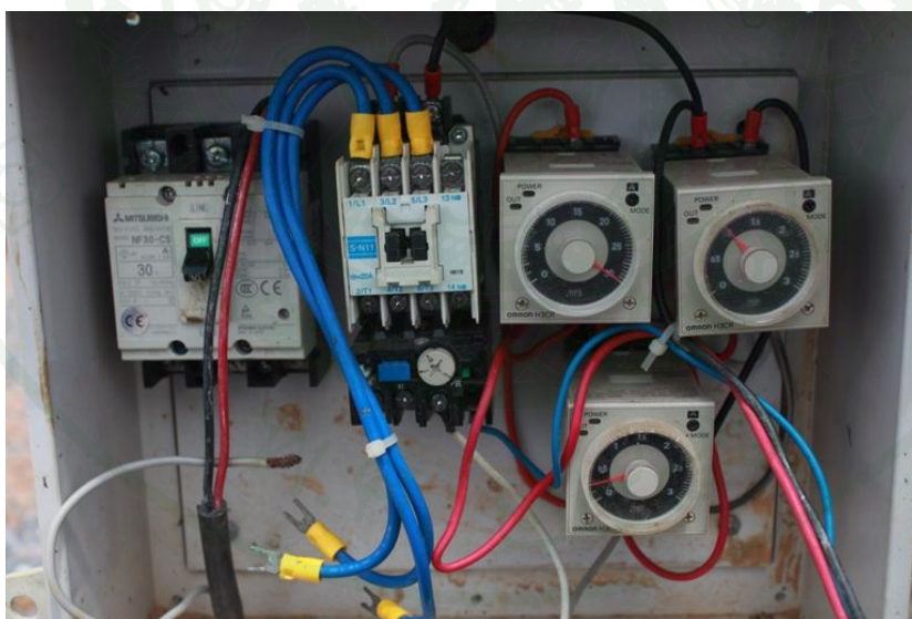
ภาพที่ 6 ตู้และนาฬิกาควบคุมการทำงานของมอเตอร์ไฟฟ้าขนาด 3 แรงม้า
