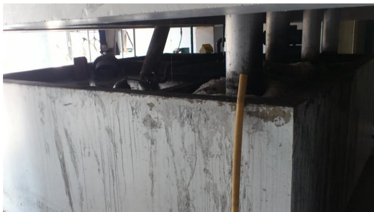
ภาพที่ 4.22 จุดรวบรวมน้ำเสียจากการลดอุณหภูมิและทำความสะอาดก๊าซชีววมวล
