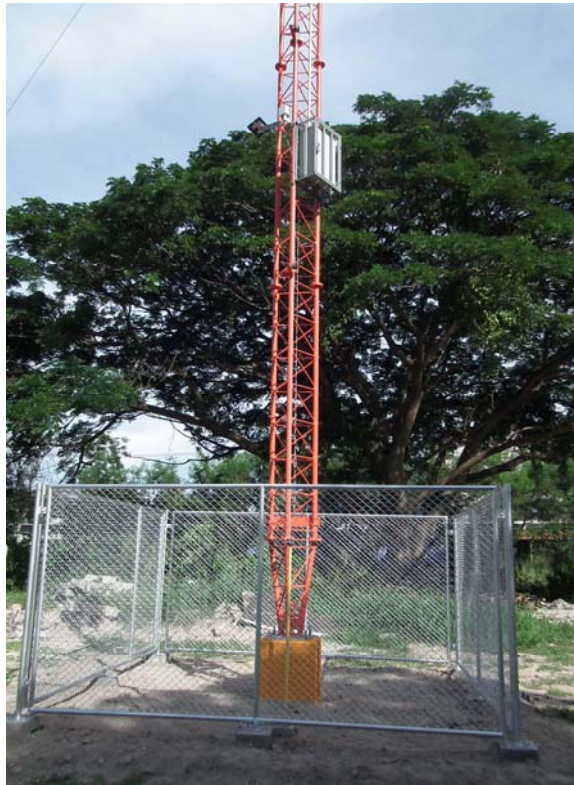
รูปที่ ก.5 รูปเสาวัดลม การติดตั้งเครื่องมือวัด เครื่องบันทึกข้อมูลอัตโนมัติ ที่ มหาวิทยาลัยบูรพา ต. แสนสุข อ.เมือง จ. ชลบุรี
