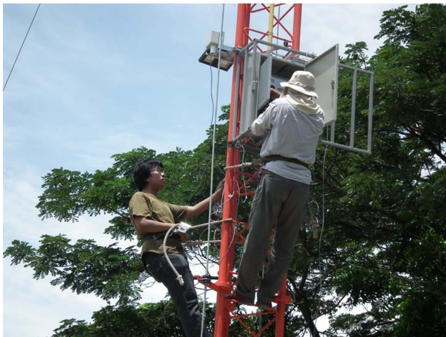
รูปที่ ก.8 แผงพลังงานแสงอาทิตย์สำหรับชาร์ตแบตเตอรี่เพื่อใช้เป็นแหล่งพลังงานให้ระบบเครื่องมือ วัดลมระบบบันทึกข้อมูล ที่ มหาวิทยาลัยบูรพา ต. แสนสุข อ.เมือง จ. ชลบุรี
