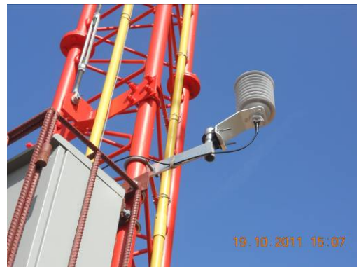
เครื่องวัดอุณหภูมิและวัดแรงดันอากาศ
