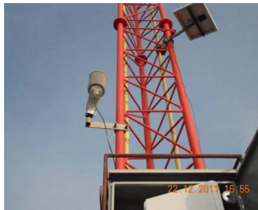
เครื่องวัดอุณหภูมิและวัดแรงดันอากาศ
