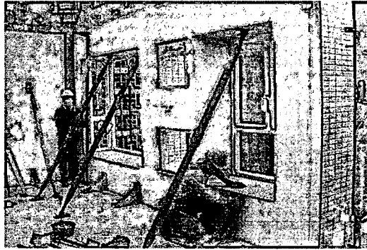
ภาพที่ 2.9 แสดงงานติดตั้งระบบชั้นส่วนสำเร็จรูประบบแผ่น ที่มา : ปรับปรุงจาก สามชัย รมทอง และ อานนท์ นันทฤชัย (2547)
