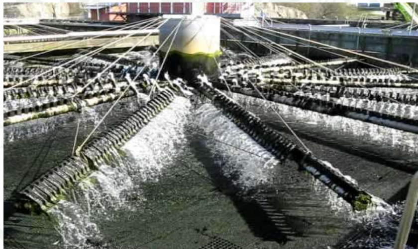
ภาพที่ 9 ถังโปรยกรอง (Trickling Filter)
