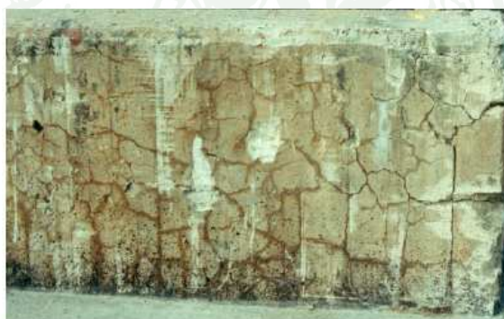
ภาพที่ 1 โครงสร้างคอนกรีตที่เสียหายจากปฏิกิริยา ASR แบบ Map-Cracking
