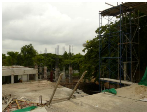
บริเวณหลังอาคารเอนกประสงค์เดิม มีการถมที่ และต่อเติมอาคารชั้นบน
