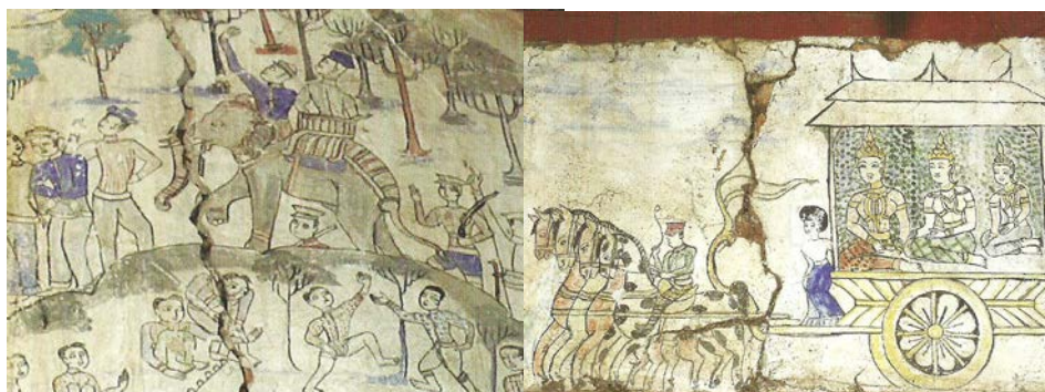
ภาพที่ 16 สภาพความเสียหายจากการแตกร้าวของผนังอาคาร
