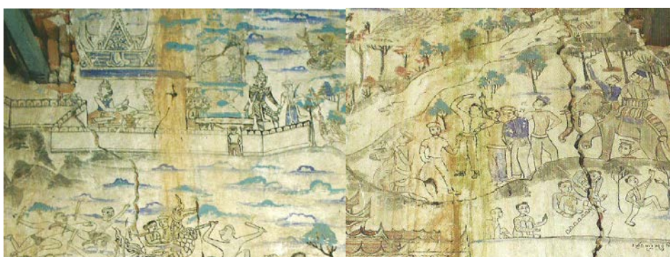
ภาพที่ 17 สภาพความเสียหายจากคราบน้ำและความชื้น
